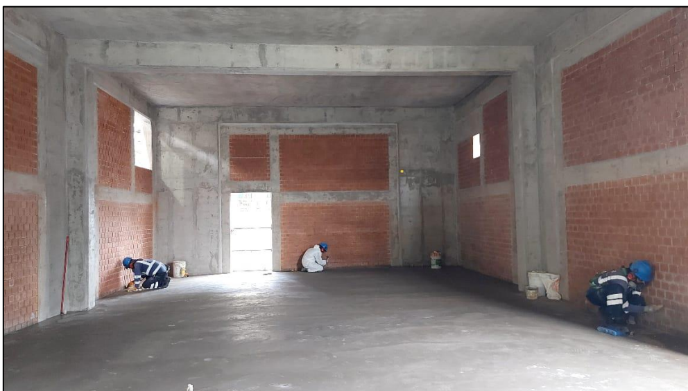
Figura 1.2 Espacio de sala eléctrica de área 70
