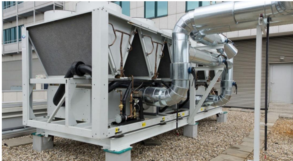
Figura 2.1 Sistema de aire acondicionado tipo Chiller
