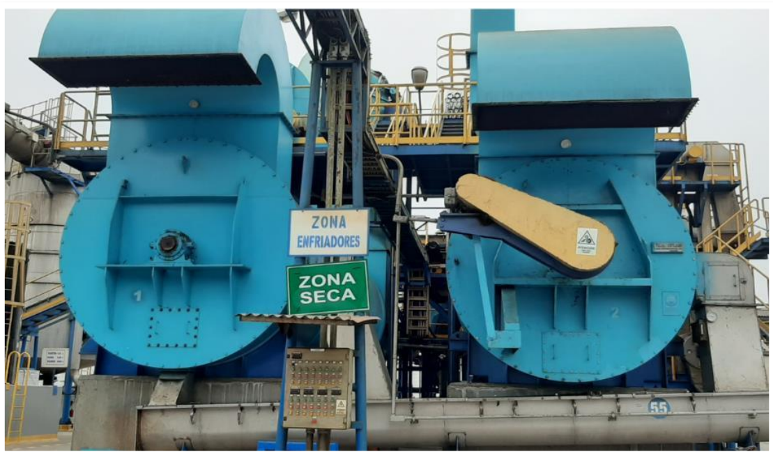
Figura 18. Enfriadores, Planta TASA Végueta.
