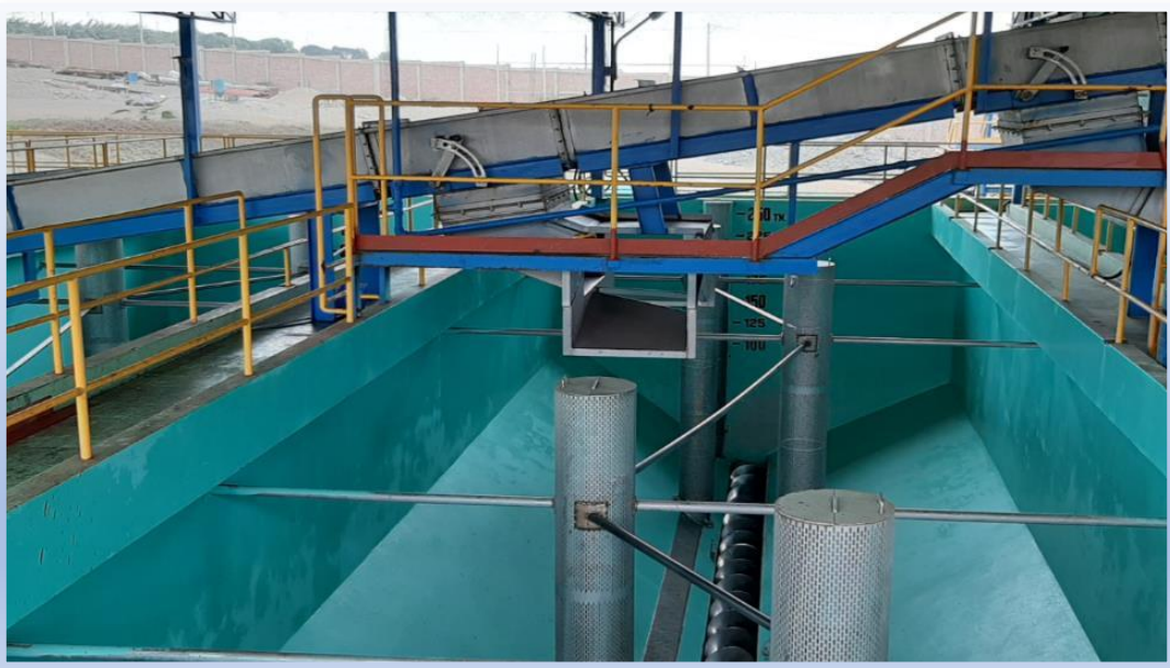
Figura 10. Pozas de almacenamiento, Planta TASA Végueta.
