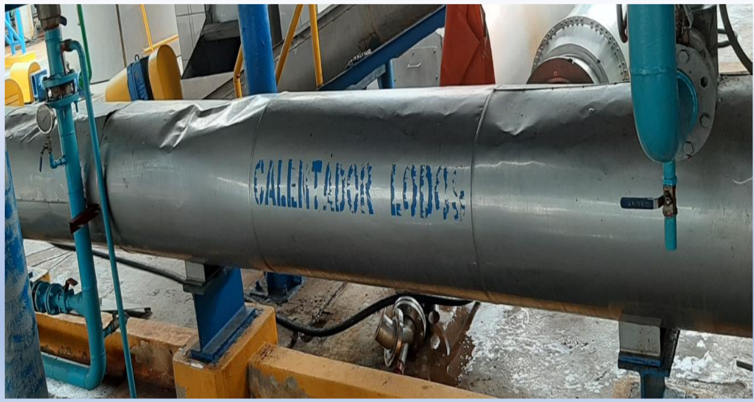
Figura 32. Intercambiador de calor, eliminar la carga bacteriana presente en el lodo ambiental, Planta TASA Végueta.
