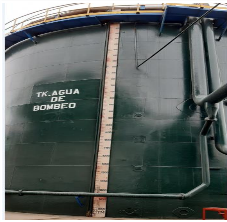
Figura 28. Tanque ecualización, homogenizar el agua de bombeo para recuperación de sólidos, Planta TASA Végueta.
