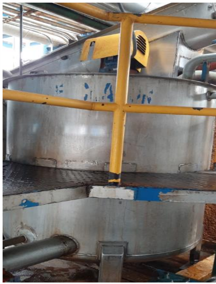
Figura 31. Mezclador, homogenizar la torta de separadora antes que ingrese al intercambiador de calor, Planta TASA Végueta.
