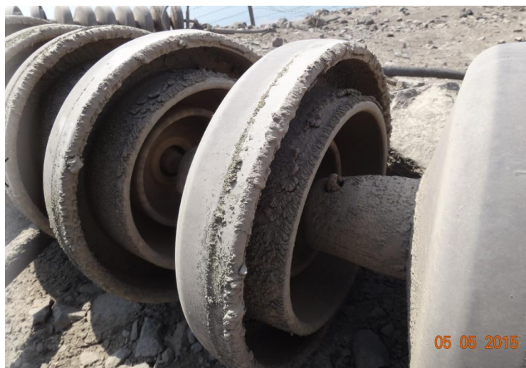
Figura 38: Aisladores recubiertos con goma silicona contaminados T542 L2110
