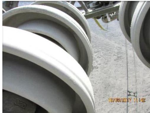
Figura 41: Aisladores después de la limpieza con trapo arpillero (L5006)
