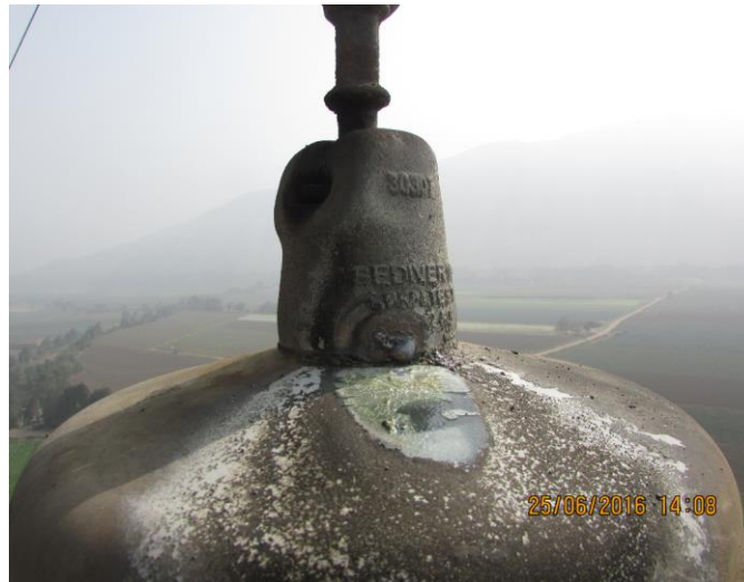
Figura 2: Pérdida de aislamiento en la torre T535 de la L2110
