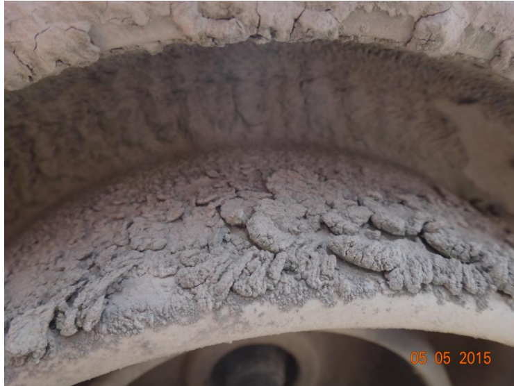
Figura 44: Contaminación en aislador recubierto con goma silicona de la L2110
