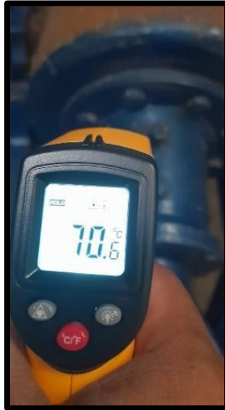
Figura 4.24 medición de temperatura en ubicación de rodamientos
